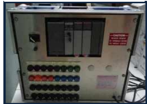
Allen Bradley SLC 5/03
