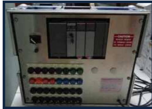
Allen Bradley SLC 5/03
