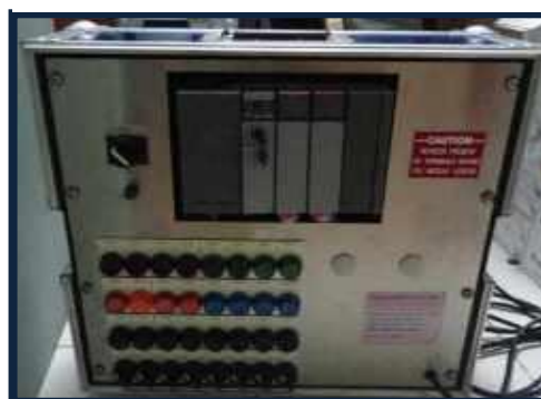
Allen Bradley SLC 5/03
