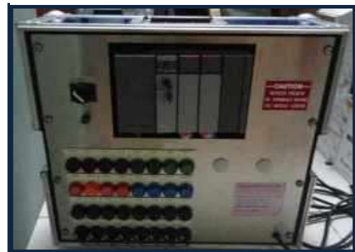
Allen Bradley SLC 5/03
