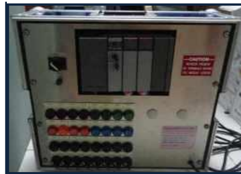
Allen Bradley SLC 5/03
